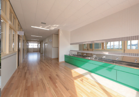
3階 廊下にある手洗い台
